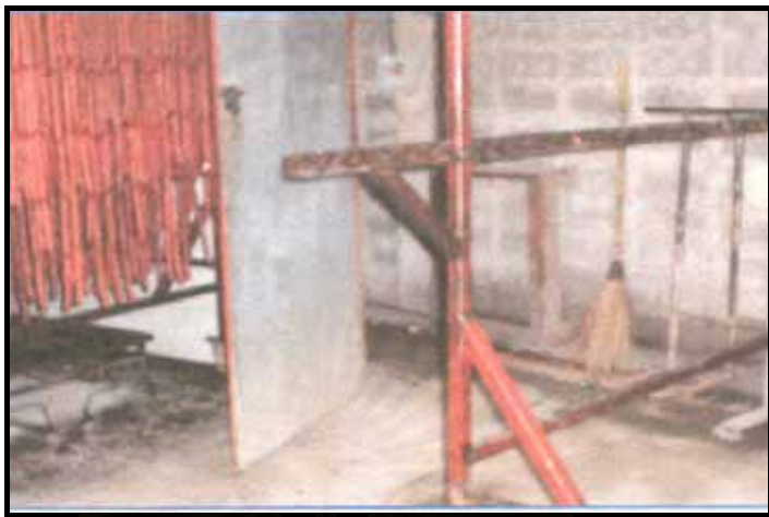
ภาพที่ 1.5 การจัดเก็บอุปกรณ์ทำความสะอาดไม่ถูกต้อง และอุปกรณ์เป็นสนิม
