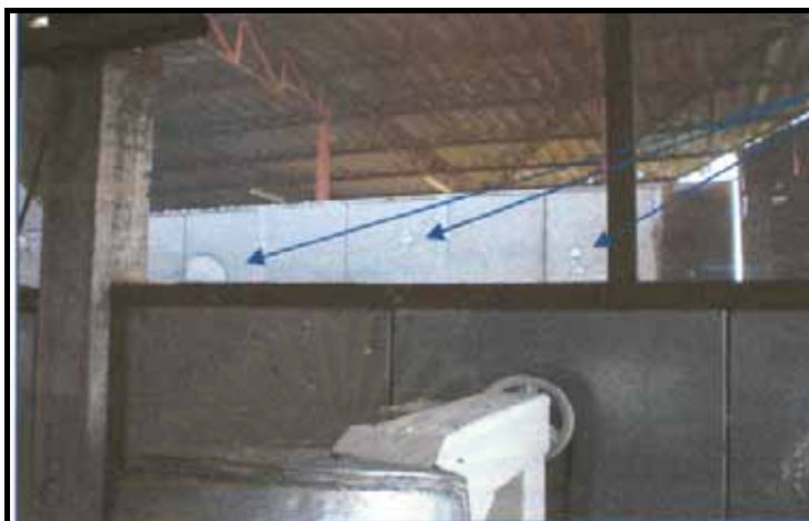
ภาพที่ 1.8 มุ้งลวดขาดและไม่มีการซ่อมแซม
