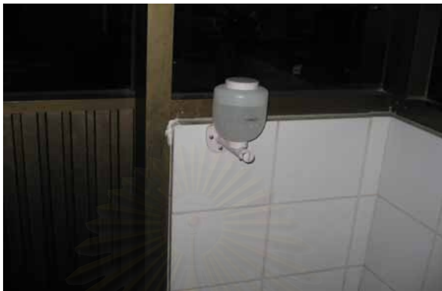
ภาพที่ 4.20 การเพิ่มติดตั้งอุปกรณ์ฆ่าเชื้อสำหรับพนักงาน
